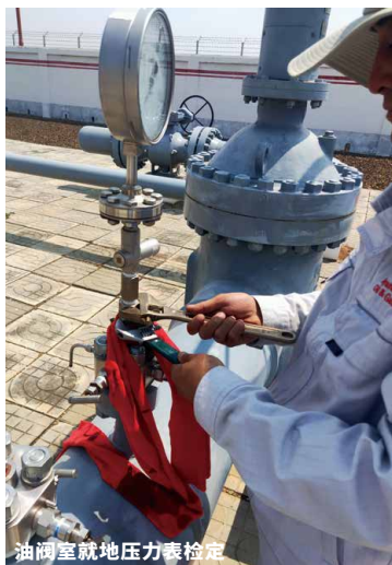
油阀室就地压力表检定
