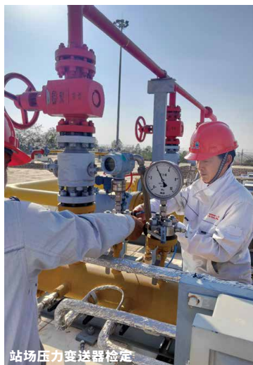
站场压力变送器检定
